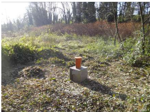
Figure 3 : Vue de la tête du piézomètre Pz 1
